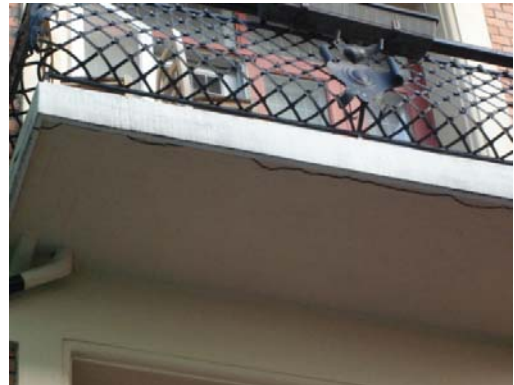
Fig 11 Sprekker i puss rundt innmurt stålramme i balkong. (Multiconsult AS)
