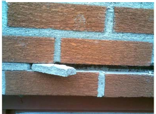
Fig 12 Fasade med innmurt armering som korroderer. (Multiconsult AS)
